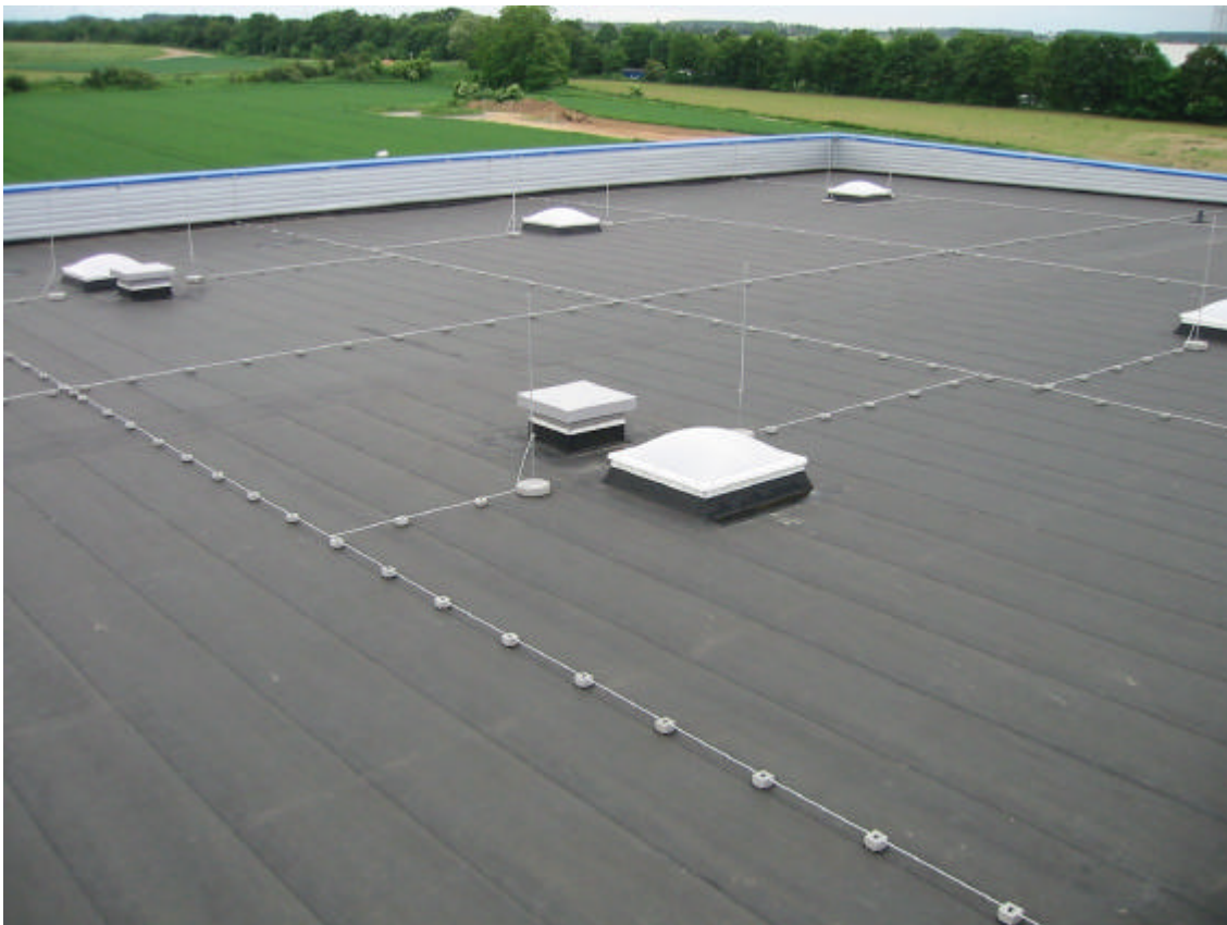
Bild 9: Fangleitungen auf Flachdach
