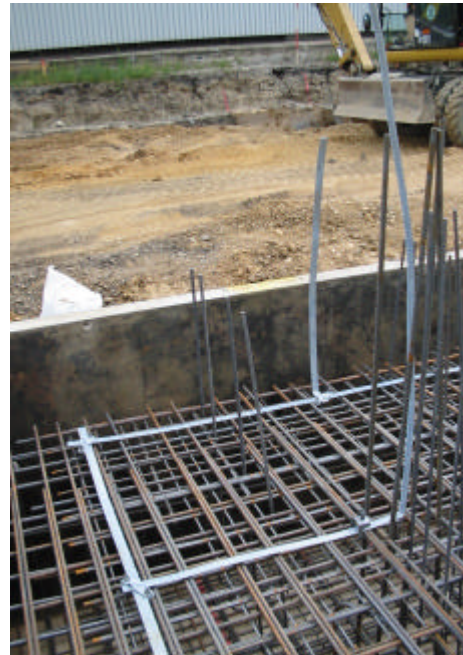
Bild 2: Anschlussfahnen vom Fundamenterder
