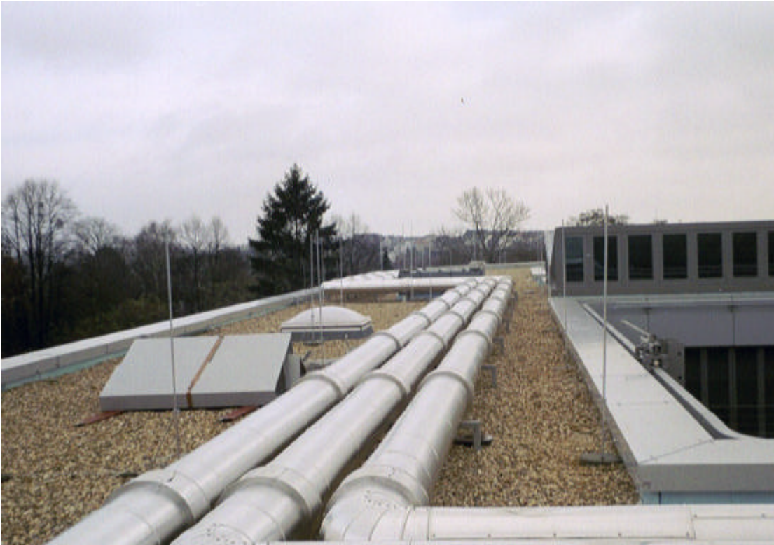
Bild 15: Durch Fangstangen geschützte Installationen auf einem Flachdach
