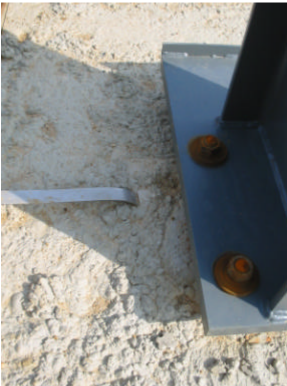
Bild 12: Fundamenterder mit Stahlträgeranschluss
